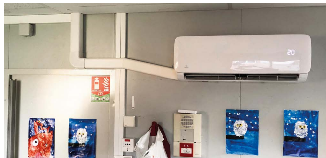
Ci-dessus : nouveau système de chauffage d'une classe maternelle.
